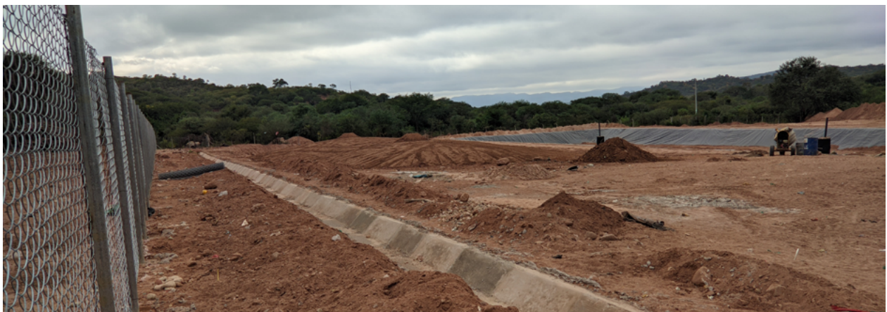
Figura 31. Cerco perimetral y cuneta pluvial de Cuevo.
