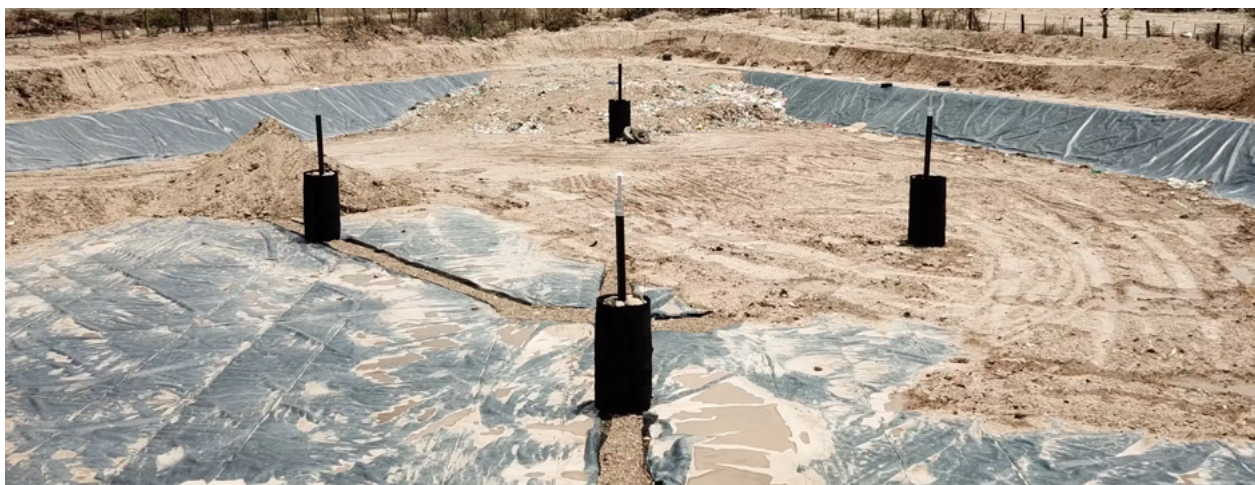
Figura 23. Captadores de biogás en una macrocelda de residuos.
